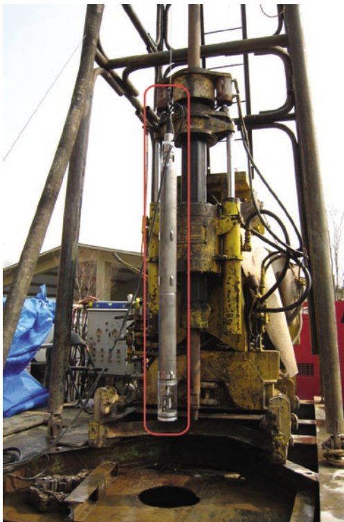
写真1 孔井に挿入される応力方位測定の地中装置(赤線で示す)。装置下部にアクリルカバーで保護されたレーザー変位計があり、孔径を測定する。
