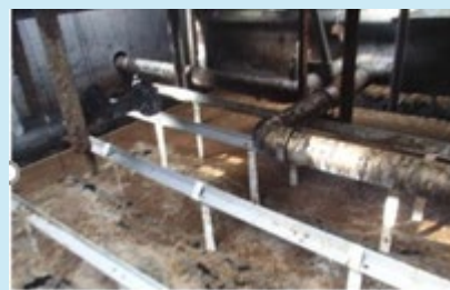
図1：炭素繊維リアクターを設置した活性汚泥処理槽
