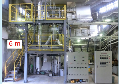
図2：100kWth循環流動床試験装置
