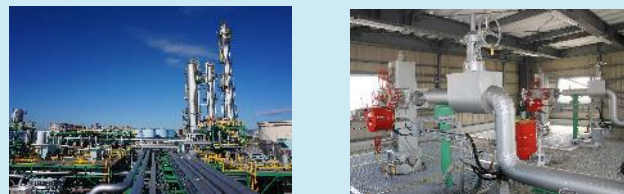
図2：苫小牧CCS実証試験センターの設備
