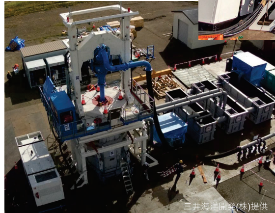
掘削試験設備全景
