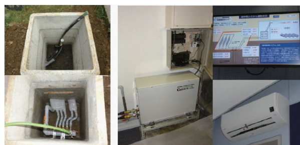
地質標本館に設置された地中熱ヒートポンプシステム、左：見学可能な熱交換器(上)とヘッダー(下)、右：館内に設置されたシステム (GSJ研究資料集No.584,p.25より)
