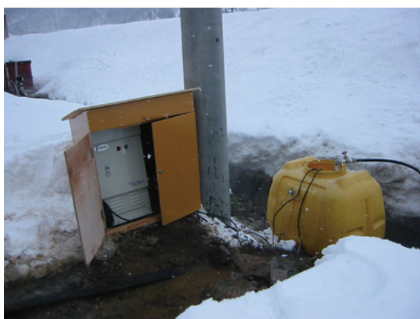
図3 電気分解装置制御盤と電極が設置されたポリタンク
