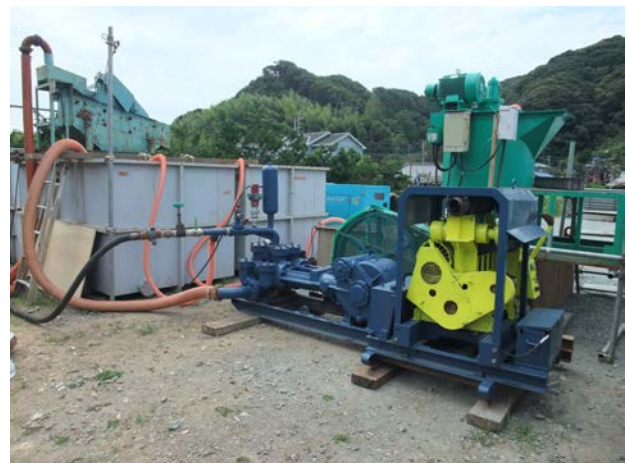
図1 南伊豆実験サイトの揚湯・涵養試験設備
