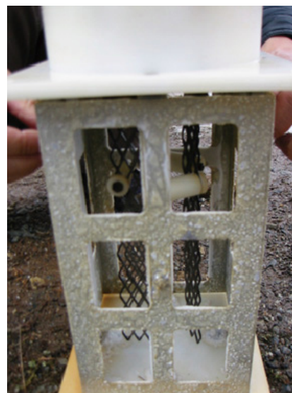
図4 試験終了後の電気分解装置の電極カバー、炭酸カルシウムが捕集されている
