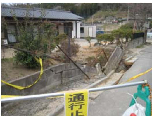
図2. 出水によって陥没が生じた道路(4月8日撮影)
