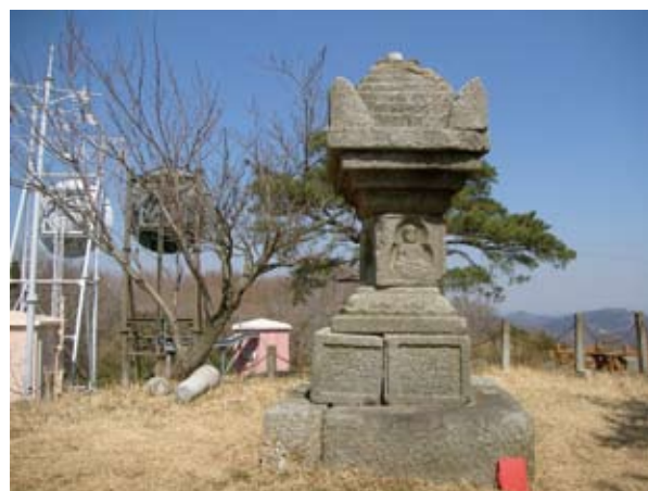
写真 5 宝篋山山頂の宝篋印塔の被災状況 （南西から見る）
