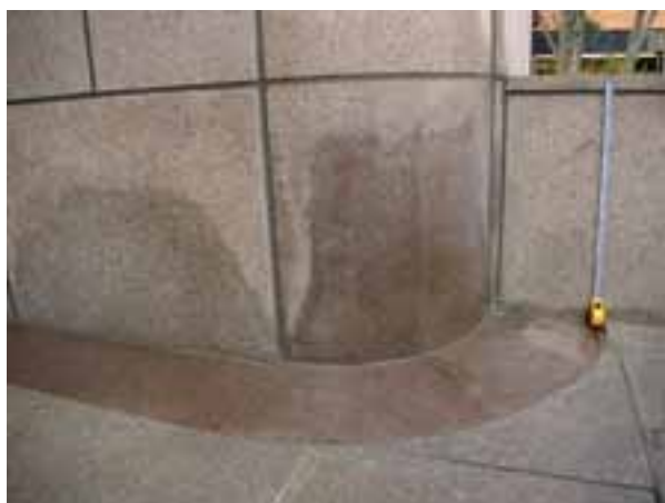
図1. 地質標本館玄関の外壁石材の劣化状況。
