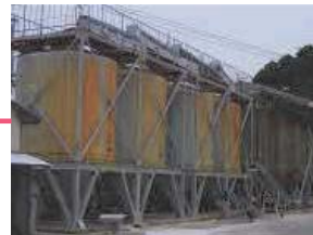
脱鉄反応槽(各40トン)
