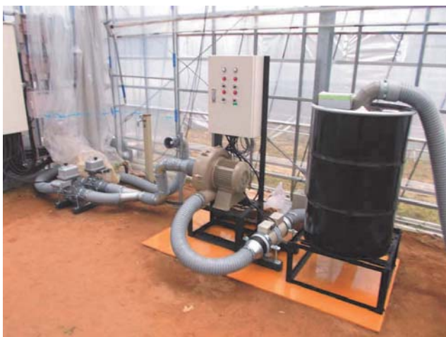
熱供給システムの外観
