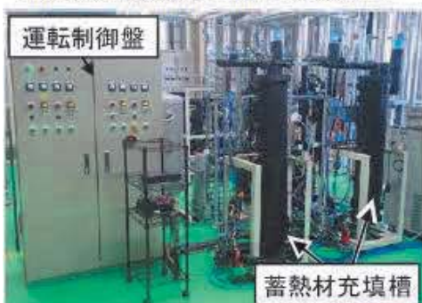
10kg級蓄熱材充填槽の試験装置
