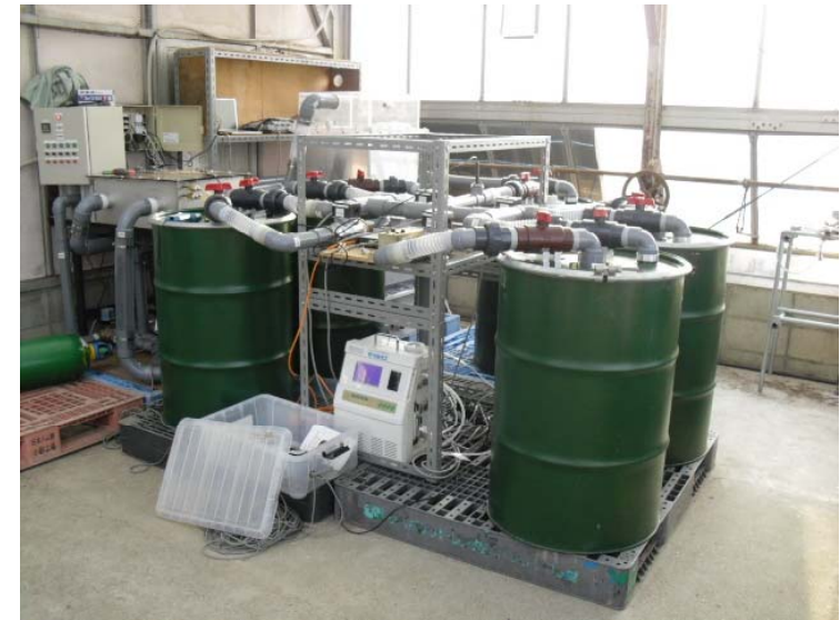
吸着塔・除湿塔
