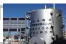
温度成層式貯湯槽
