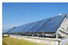
再エネ熱源（太陽熱パネル）
