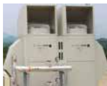
補助熱源（ヒートポンプ）
