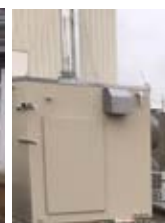
実証実験に用いた熱源装置
