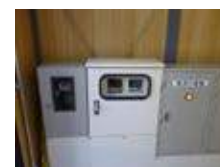
揚水量調整制御盤
