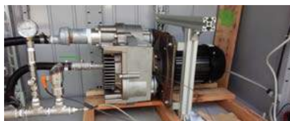
5kW級スクロール膨張機を用いた水蒸気発電試験機（動力部）
