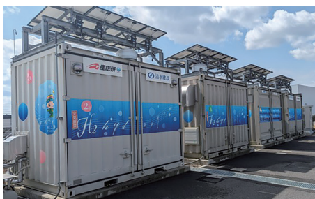
建物付帯型水素エネルギー利用システム (Hydro Q-BiC ® ) の開発
