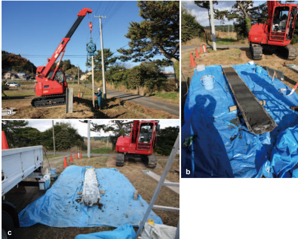
第2図. 地点GS-TMKにおける調査風景写真. a: クレーンを使用した大型ジオスライサーの採取風景. b: 採取されたジオスライサー. c: 試料を剥ぎ取り剤によって養生した状態. Fig. 2. Photographs of geoslicing in GS-TMK. a: Taking geoslice sample using a crane truck. b: Geoslice sample. c: Geoslice sample covered with grout.
